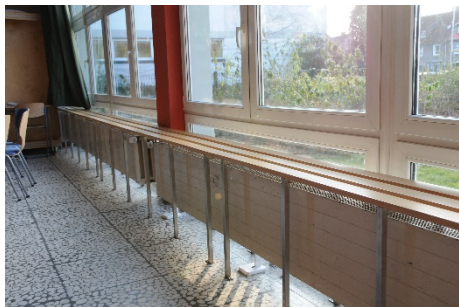
2015 ... Heizkörpersitzbänke im SLZ ca. 2200,- Euro
