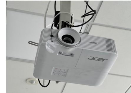
2022 ... Anschaffung zweier Beamer als Ersatz für defekte Geräte ca. 1100,- Euro
